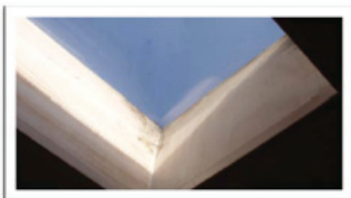
Ovenlysvindue i bad: 1-lags Plexiglas med dårlig isoleringsværdi Der ses mørke aftegninger i træværket.
