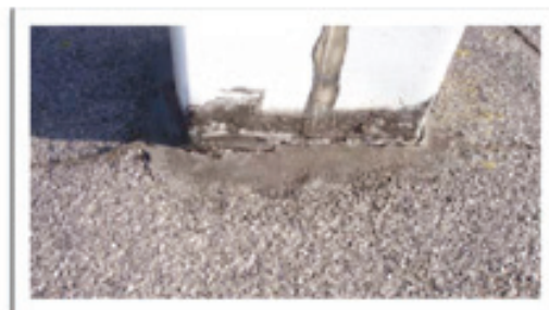
Der er utæt fuge omkring skorsten.
