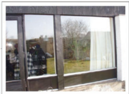
Huset set fra syd: Sokkel mangler puds og har revner.
